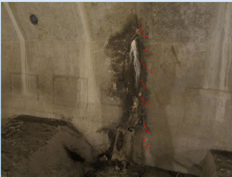
Косые трещины в стыке
