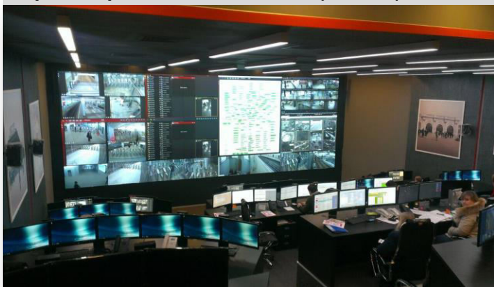
Пункт управления обеспечением транспортной безопасности (ПУОТБ)
